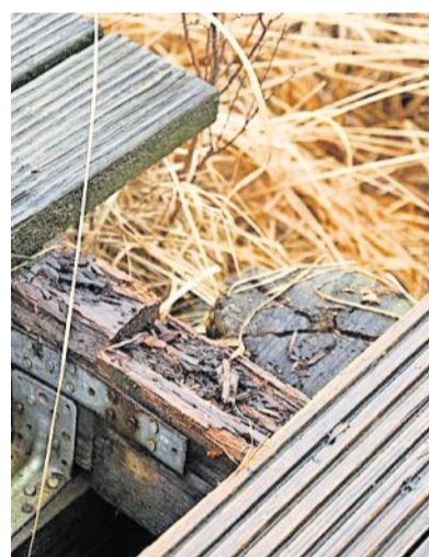
Viele Holzstege auf dem Moorerlebnispfad in Flögeln sind marode wie dieser. Stadt und Landkreis arbeiten an einer Lösung. Foto: Schoener
